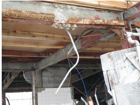
建物に残存した吹付け材
