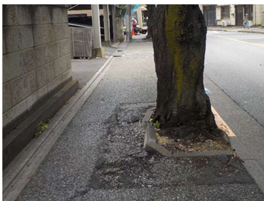
根による舗装や縁石の持ち上がり
