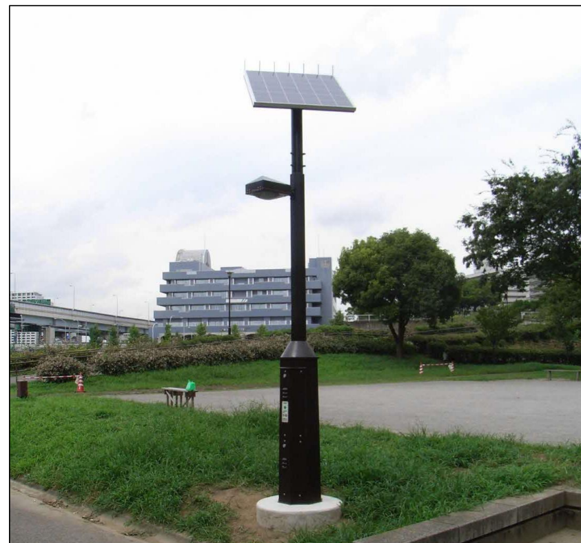
非常用照明（ソーラー照明式）
