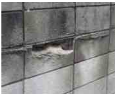
危険なひび割れ、かけ
