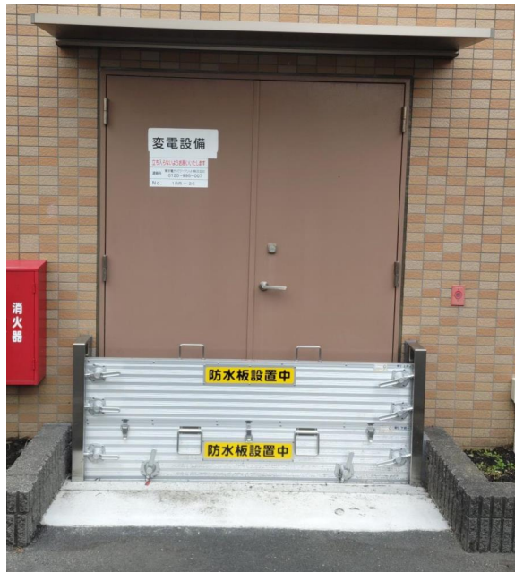
本助成金を活用し集合住宅に設置した止水板
