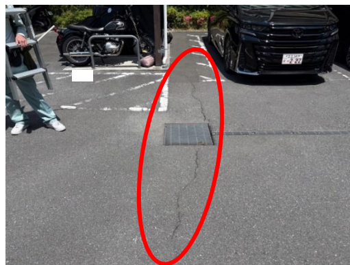
ひび割れの様子
